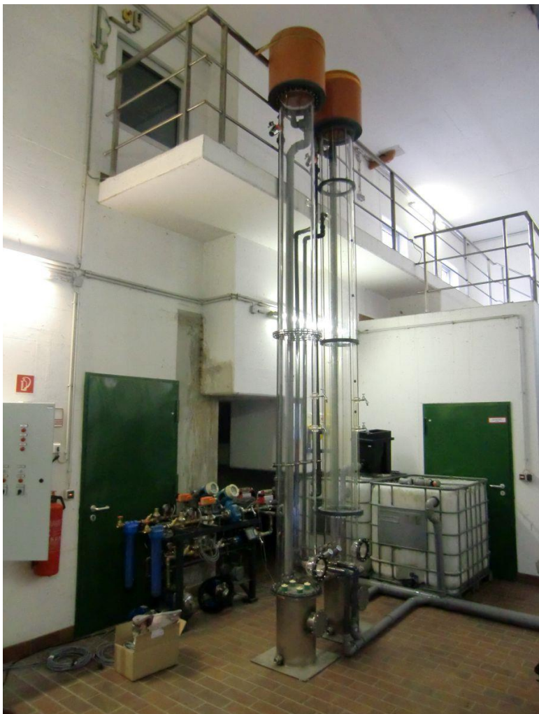
Bild 11: Halbtechnische Filtersäulen im Filtergebäude des KRO (Stand: 11/2013)
