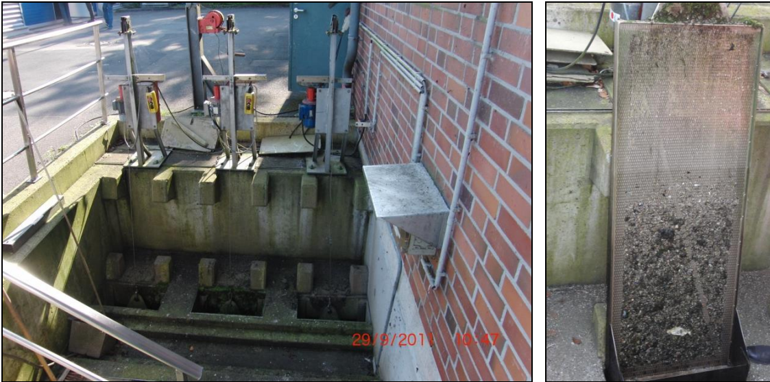
Bild 51: Einbausituation der vorhandenen Lochbleche (links); herausgezogenes Lochblech mit Verschmutzung (rechts)
