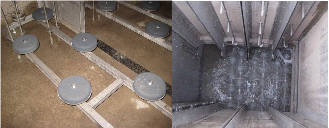
Bild 14: Diffusorengitter am Boden des Ozonreaktors (links: Nahansicht, rechts: Draufsicht bei Sauerstoffeintragsversuch)
