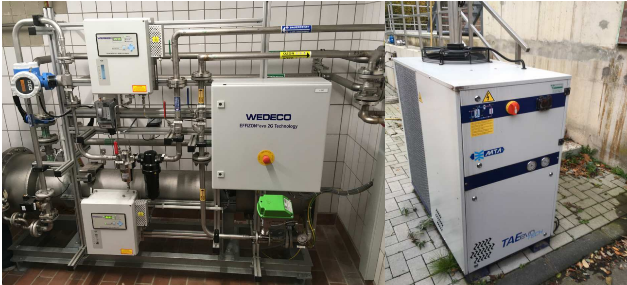
Bild 13: Ozonerzeuger (links) und Kühler (rechts)
