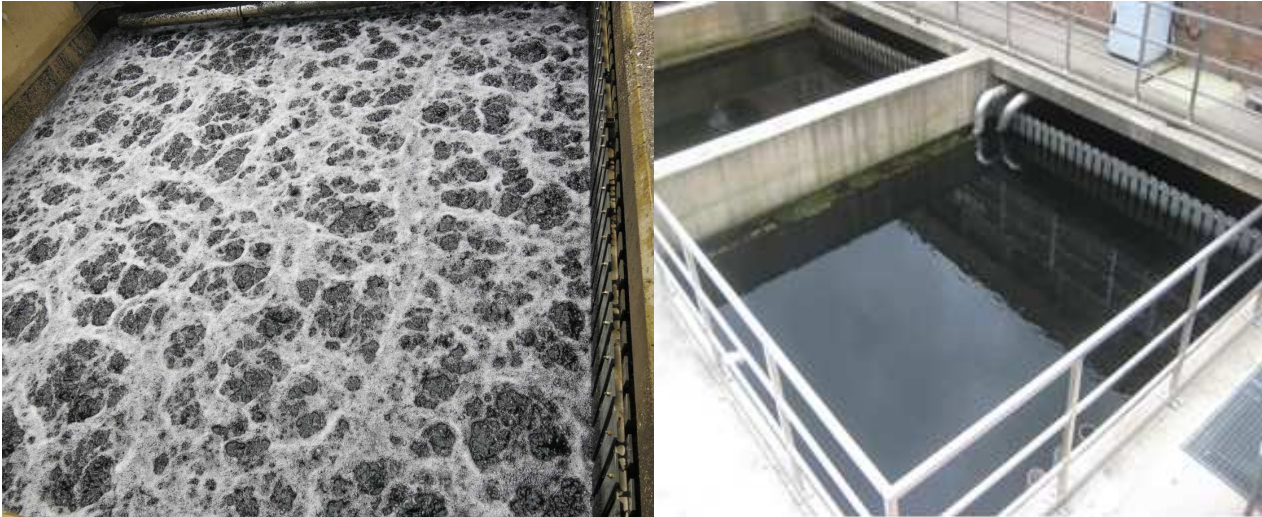
Bild 20: Filter mit granulierter Aktivkohle bei Spülung (links) und bei Filterbetrieb (rechts)
