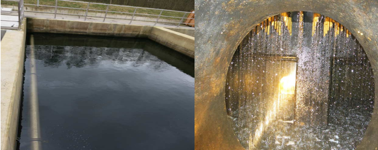
Bild 24: Referenzfilter im Filterbetrieb (links) und Blick durch Mannloch unterhalb des Filterbodens (rechts)
