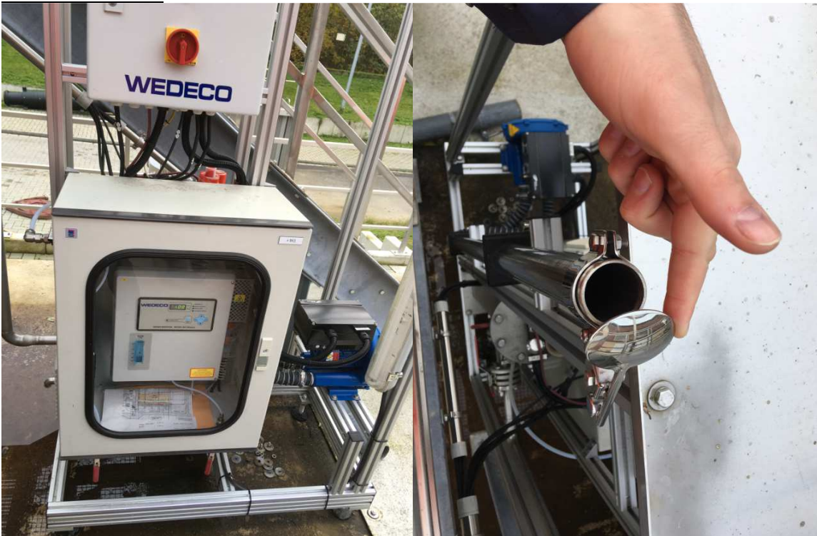
Bild 16: Restozonvernichter (links) und oberseitiges Auslassrohr (rechts)
