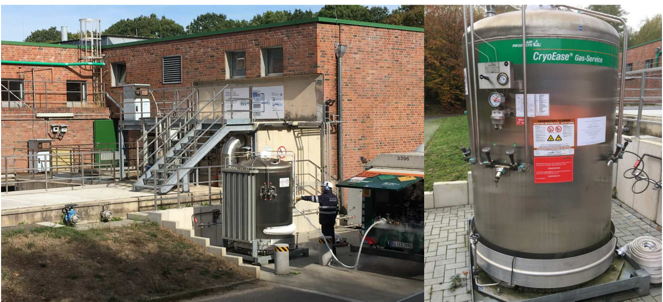
Bild 12: Sauerstofftank (links: während Befüllung, rechts: Nahansicht)
